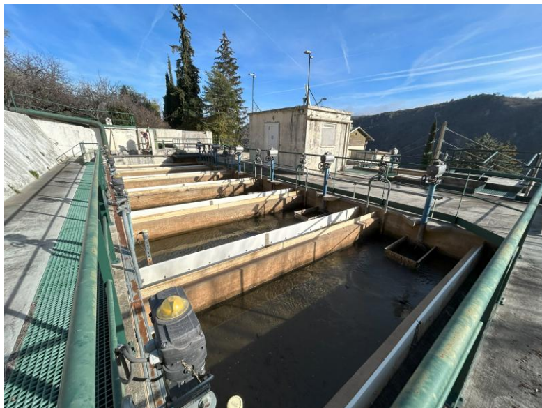
Usine du SIEVI – Filtres
