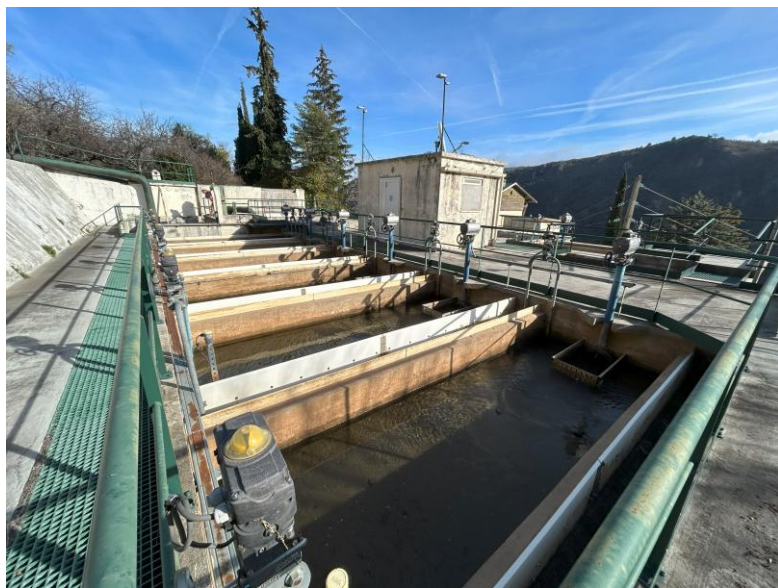
Usine du SIEVI – Filtres
